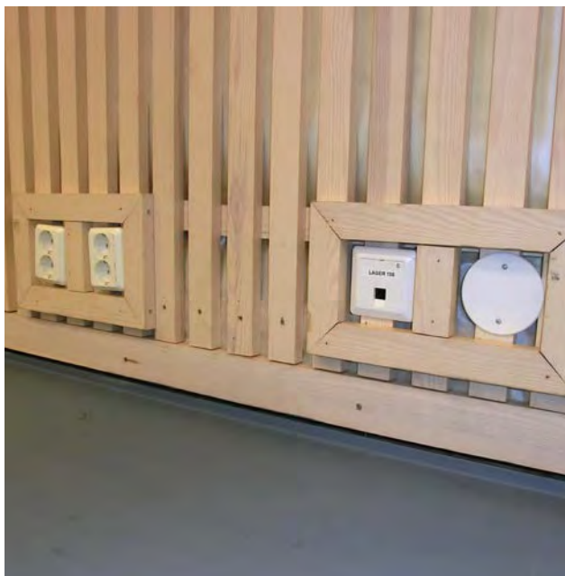
Beskyttelse av elektriske installasjoner Foto: Morten Roa
