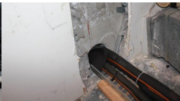
Bilde 24 viser rør som føres gjennom branncelle-begrensende skillevegg i ventilasjonsrom.
