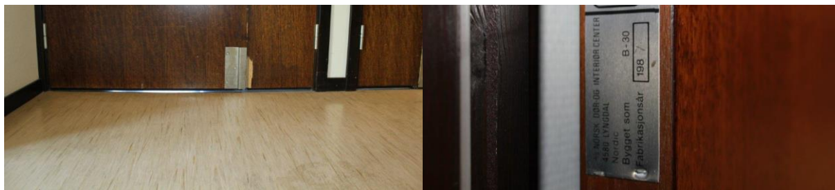
Bilde 13 viser glippe mellom dørblad og gulv i dør til sengerom i Raud avdeling. Dørblad er også skadet.
