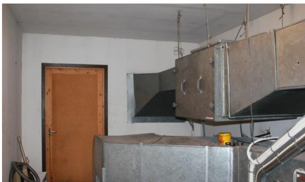
Bilde 27 viser ventilasjonsaggregat og oppheng.
