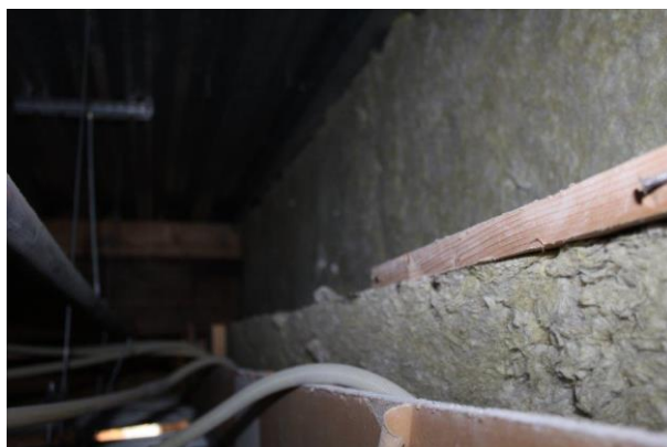
Bilde 19 viser utførelse av brannskille over himling i raud avdeling mellom rømningsvei og sengerom.
