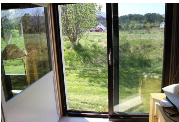
Bilde 35 viser rømningsdør til det fri i enden av rømningskorridor. Legg merke til terskel på skyvedør og låssystem.
