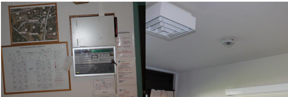
Bilde 29 viser brannalarmsentral i vestibyle.
