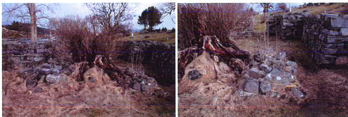
Figur 32 og 33. Bileta over viser kar 7 og 8. Begge er totalskadd grunna trevelt
