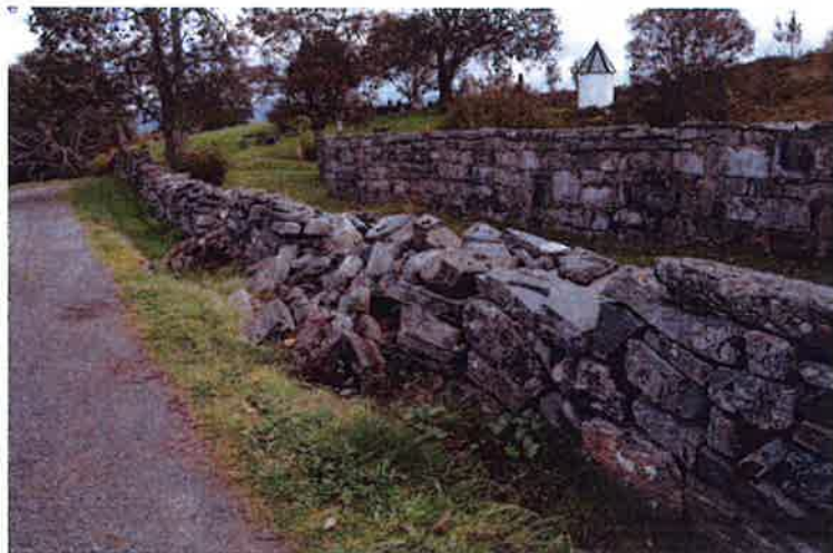
Utrasing i kyrkjegardsmur, to stadar i muren i yngre mur mot nord.
