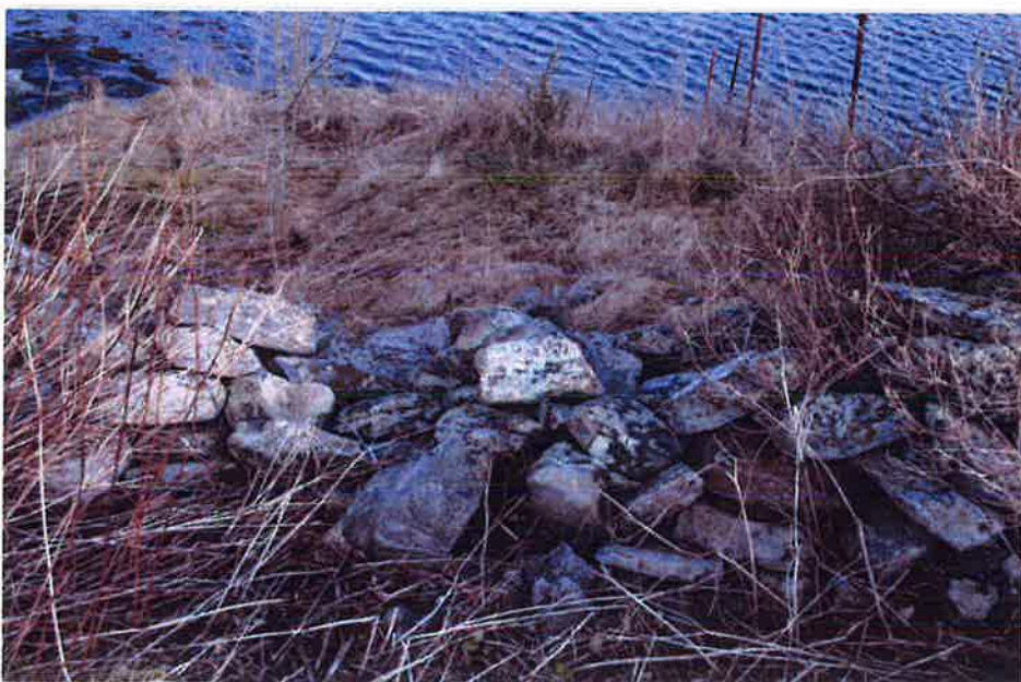
Figur 10. Parti 3 av kyrkjegardsmuren. Utrasing, hovudsaklig mot aust.
