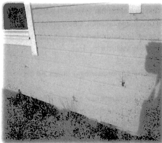
Bilde 10:Utvendig fasade bør beisast/ utbetrast
