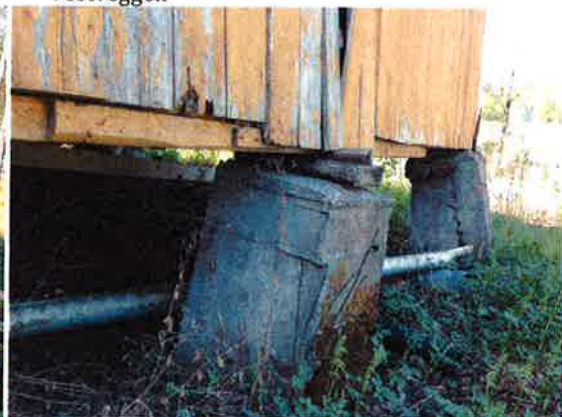
Ein av pillarane som helde på å dette ned, midtstolpen har falt ned under lenger bak
